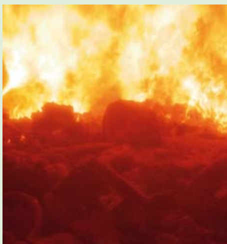
Das Feuer in den zwei Öfen der KVA Thurgau brennt 24 Stunden lang rund um die Uhr und erzeugt dabei zur Hälfte CO 2 -neutralen Strom sowie Wärmeenergie in Form von Dampf.
