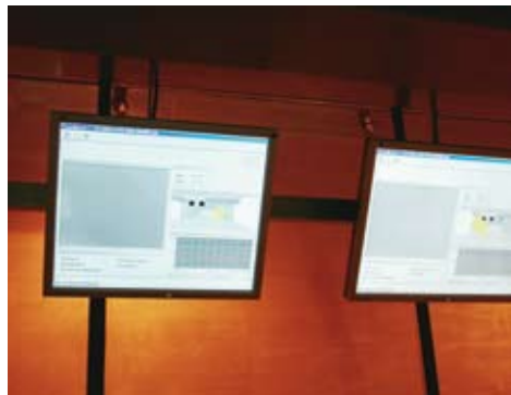
Überwachungsmonitore des Bunkerbrand-Früherkennungs-Systems
