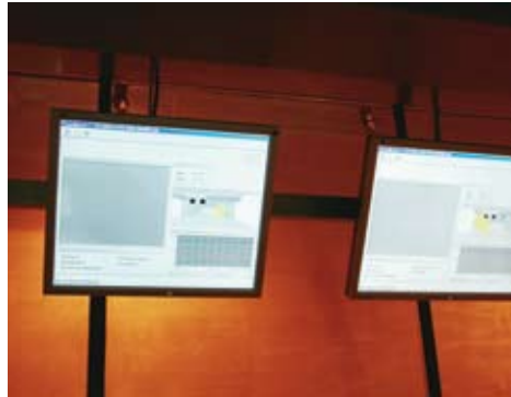
Überwachungsmonitore des Bunkerbrand-Früherkennungs-Systems
