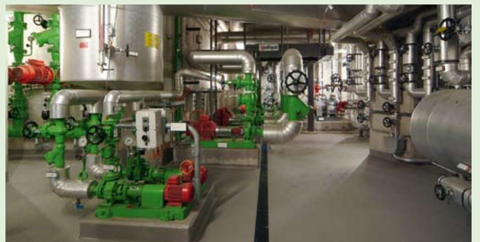
In der Hochdruckzentrale kommt der Dampf herein und wird im Hochdruckverteiler auf die Turbine zur Stromerzeugung und in die verschiedenen Dampfleitungen (Model, Schulhaus) geleitet.
