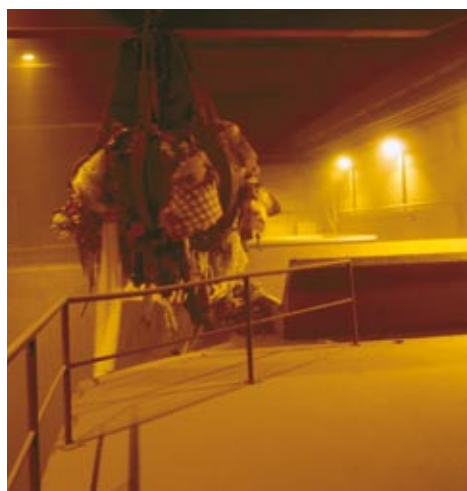
Kehrichtbunker mit Kran.
