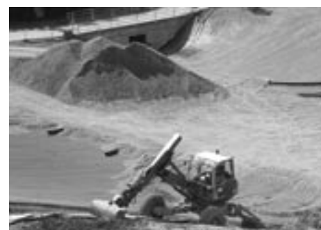
Ausbau der Reaktordeponie Mühletobel in Berg, die jetzt zum Verband KVA Thurgau gehört.
