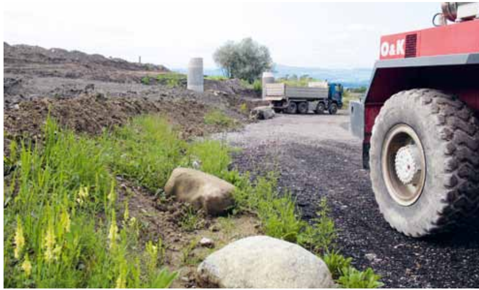
Mit Lastwagen werden Altlasten und Sonderabfälle in die einzige Reaktordeponie des Thurgaus angeliefert. Betrieben wird diese vom Verband KVA Thurgau.
